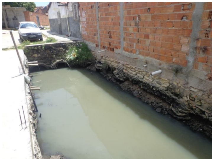
Figura 3.43 – Despejo de esgotos no rio.
