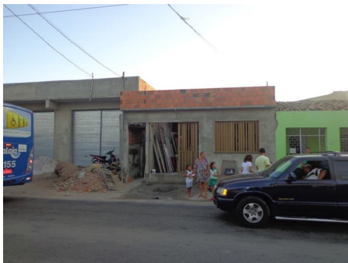
Figura 3.29 – Residência que deverá ser retirada para passagem da avenida com obras em andamento.
