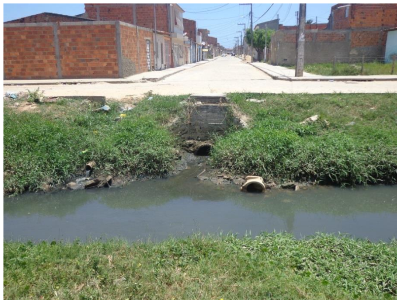
Figura 3.49 – Lançamento de esgoto próximo às residências.
